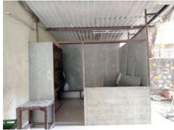
सीनियर रेलवे इंस्टिट्यूट, सांताक्रुज पूर्व के अंदर किया जा रहा अनधिकृत निर्माण।
